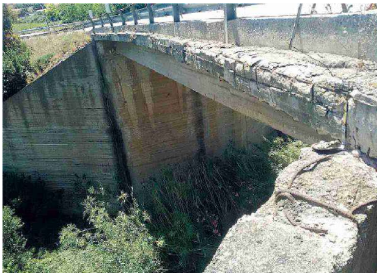
A19. Il ponte da risanare sul torrente Barratina a Termini Imerese
